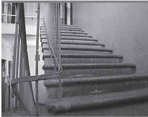
В акте о признании дома аварийным эти лестницы значатся как «деревянные»
