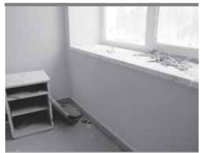
Ремонт не закончен: всюду в коридорах строительный мусор
